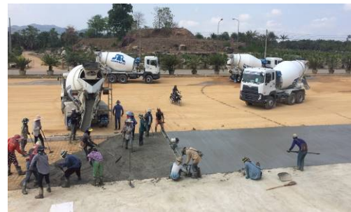
รูปภาพตัวอย่างหน้างานการเทคอนกรีตผสมเสร็จ
